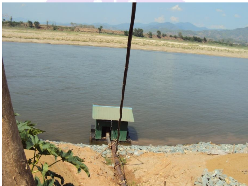
ภาพ 1 แสดงลักษณะของสถานีสูบน้ำด้วยไฟฟ้าริมฝั่งแม่น้ำโขง
